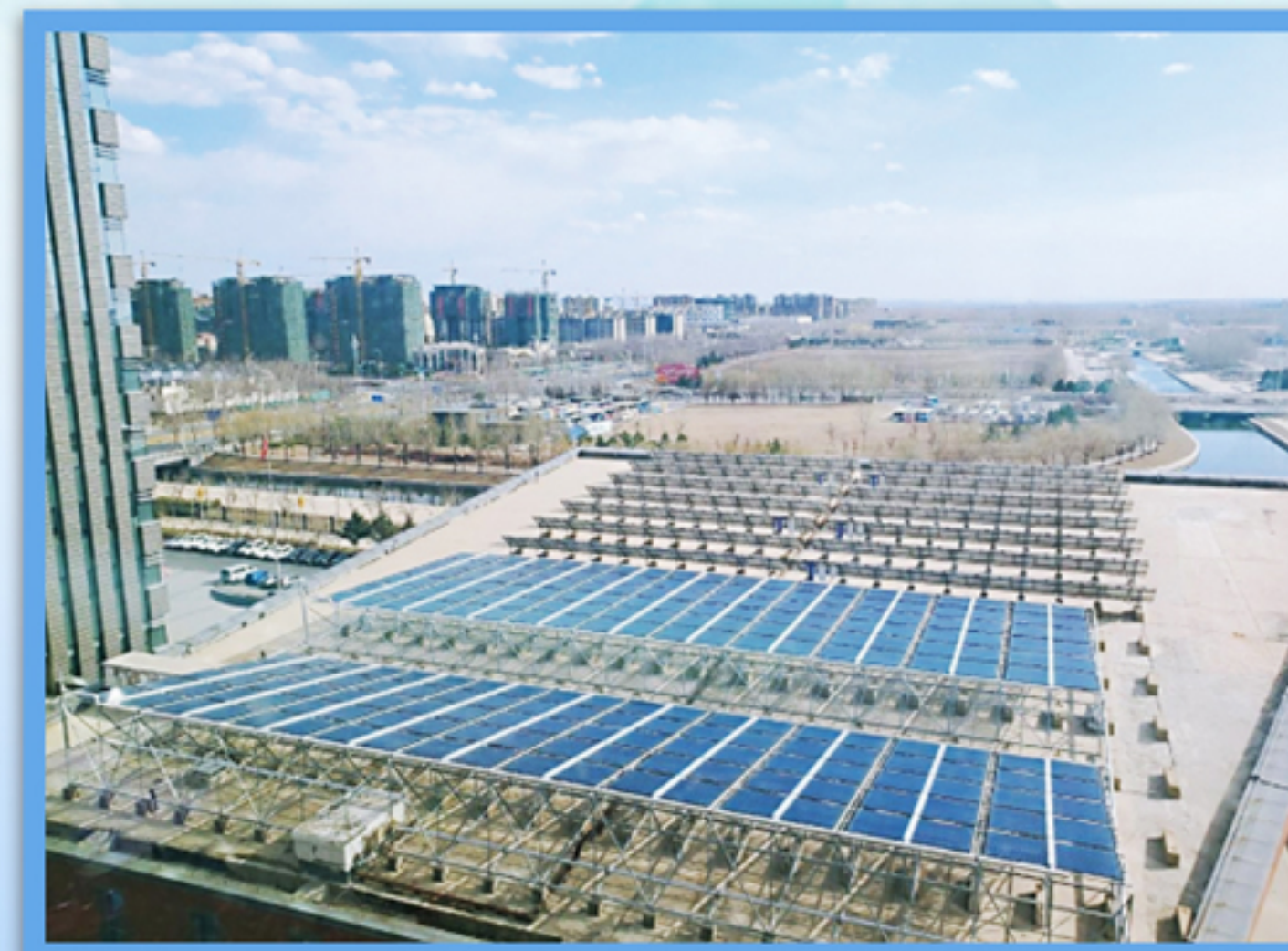
制热节能改造项目
