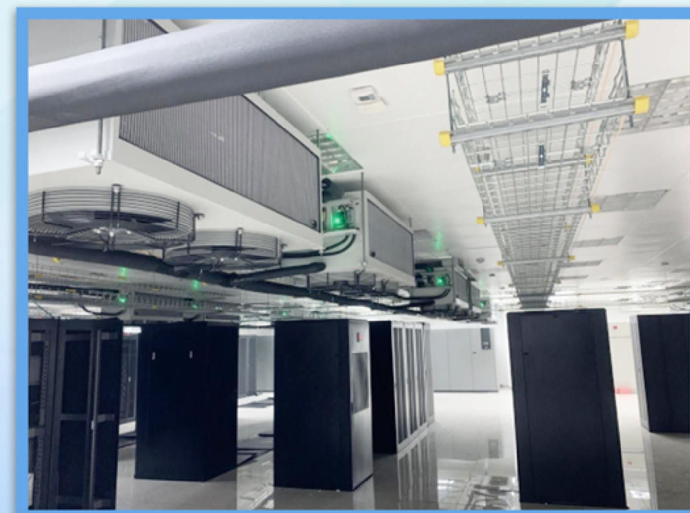
空调系统节能改造项目
